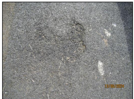
(Damaged wet pour)
